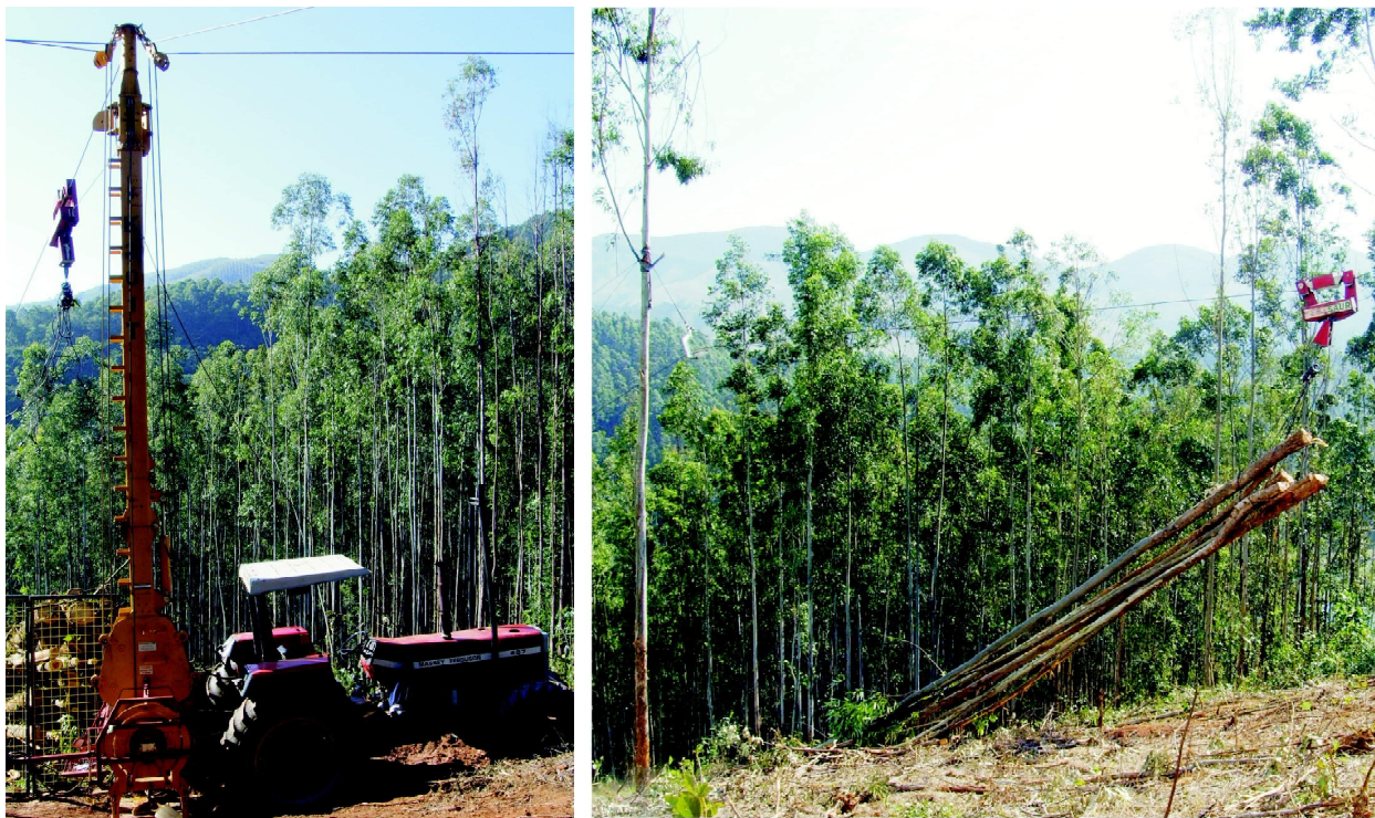
Figura 1 – Vista geral do cabo aéreo.
