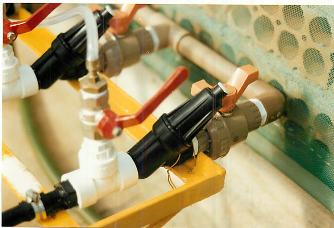
FIGURA.1 Vista lateral do sistema inicial de cada linha de tubogotejador, composto de: registro de esfera de PVC, válvula reguladora de pressão e tê conectado a registro de esfera metálico.
