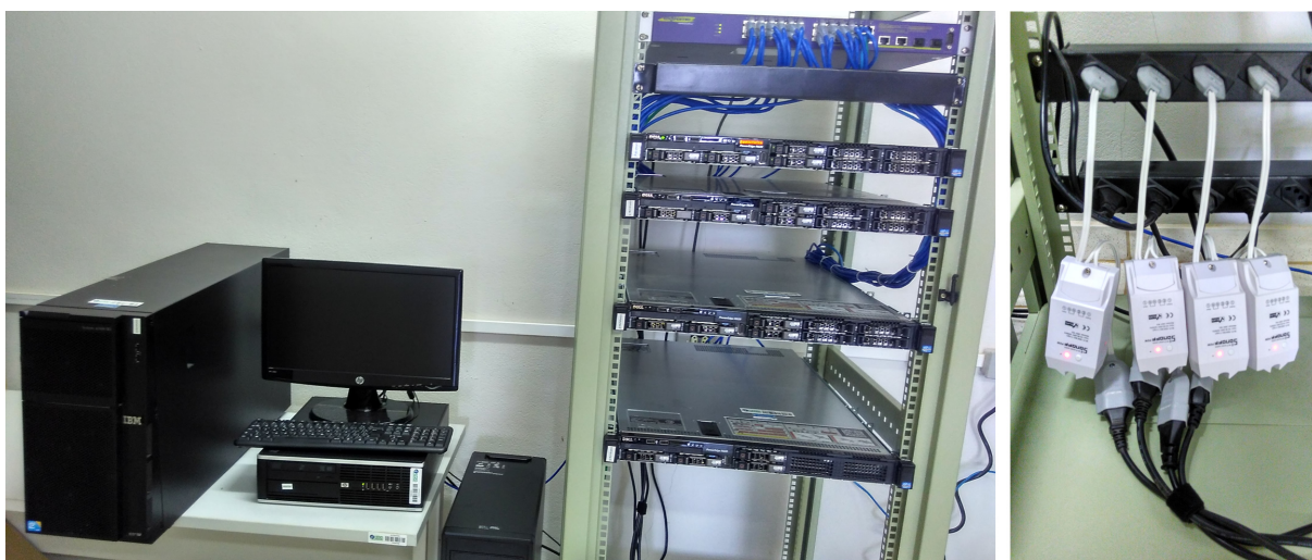
Figura 18 – Servidores, Switch e Wattímetros no Data Center GrubiCom
