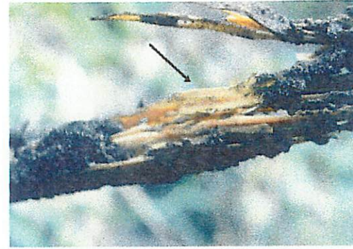
FIGURA 2A Dano severo de Coptotermes havilandi em estacas de pinho.
