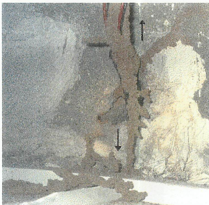
FIGURA 14A Presença de túneis suspensos em apartamento de cobertura.
