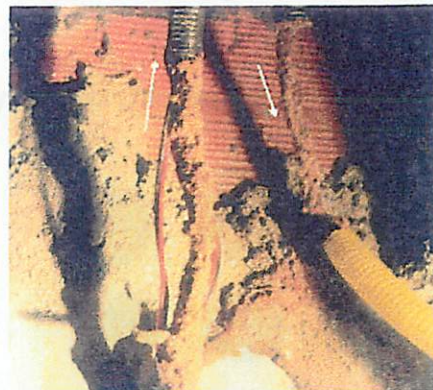
FIGURA 10A Túnel suspenso de cupim subterrâneo em apartamento de cobertura em Ipanema, RJ.
