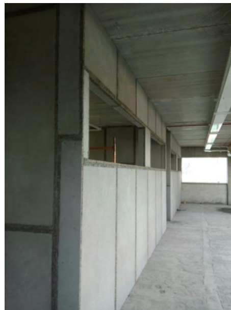
Figura 3 – Parede divisória de pannel cimento-madeira.
