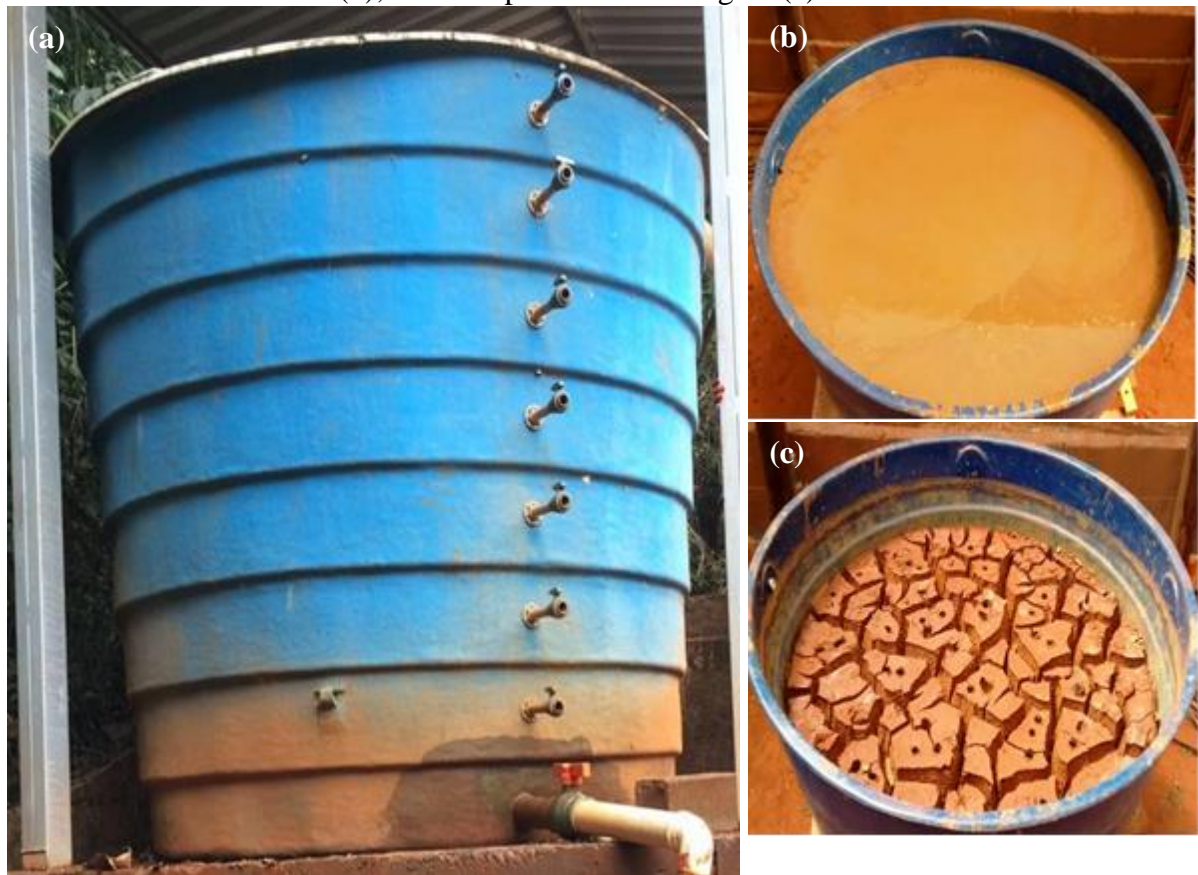
Figura 1 - Tanque de adensamento do efluente da lavagem dos filtros e decantadores da estação de tratamento de água da UFLA (a); leito de secagem do efluente da ETA após adensamento (b); lodo em processo de secagem (c).
