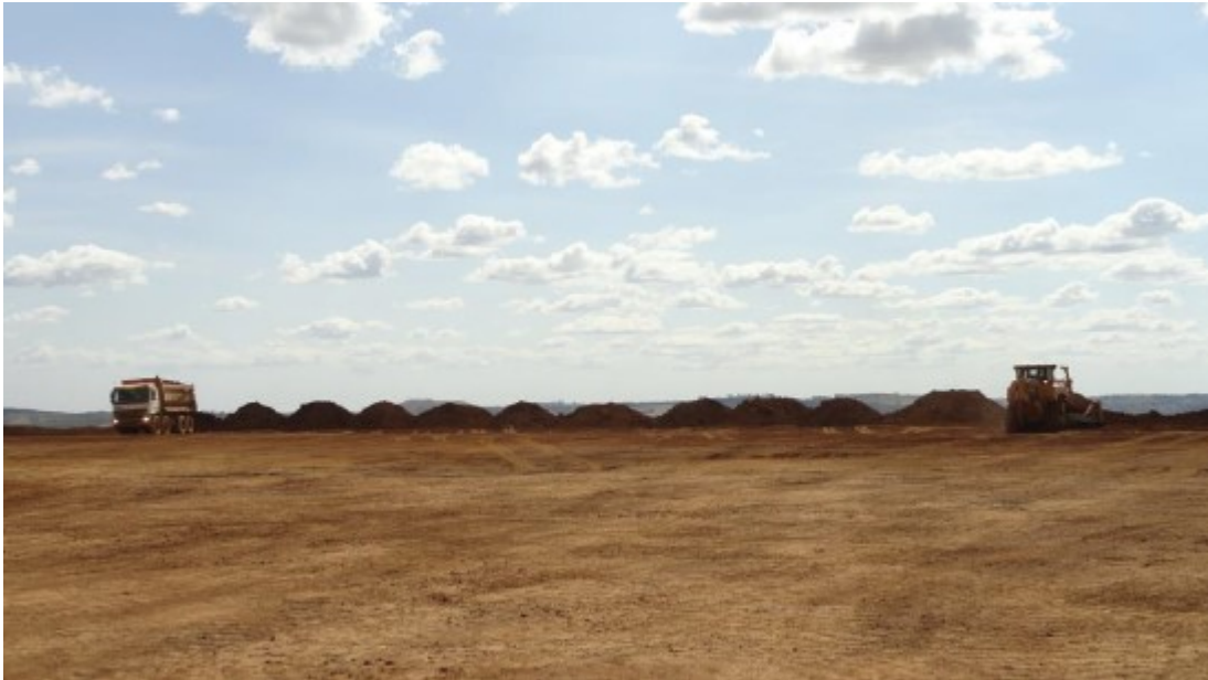
Figura 6: Lançamento de topsoil no talude da Pilha de Estéril. Fonte: Vandeir Toledo.
