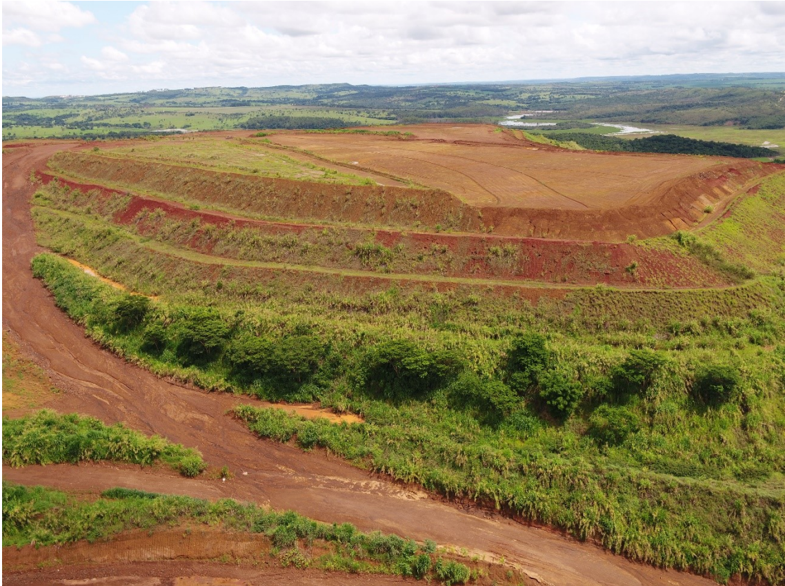
Figura 5 - Foto aérea do depósito de estéril e as dimensões de seus taludes.
