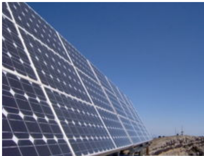
Figura 05 - Arranjo de painéis fotovoltaicos.
