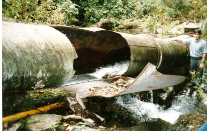
Figura 34- Tubulação rompida por excesso de pressão.
