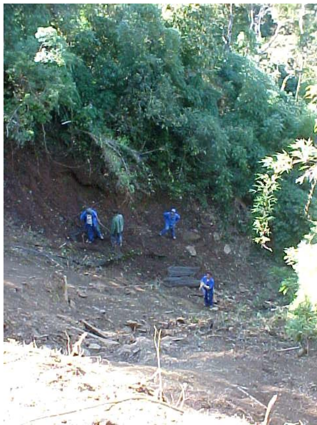
Figura 28- Dano à encosta abaixo do canal de adução mostrado na figura 27, pela obstrução por um pequeno deslizamento de terra. O dano maior foi causado encosta abaixo, pelo transbordamento do canal.
