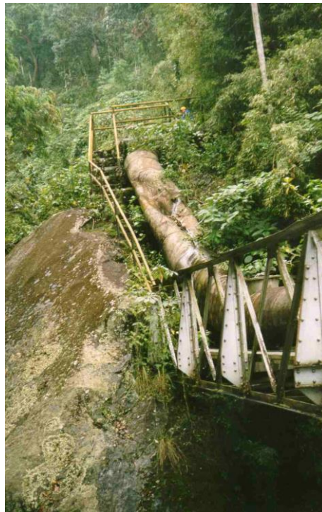
Figura 35- “Murchamento” da tubulação forçada por pressão externa.
