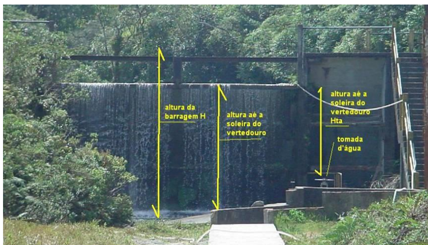
Figura 19- Exemplo de barragem com vertedouro. O cálculo da profundidade da tomada d'água H_{ta} é feito a partir da soleira do vertedouro
