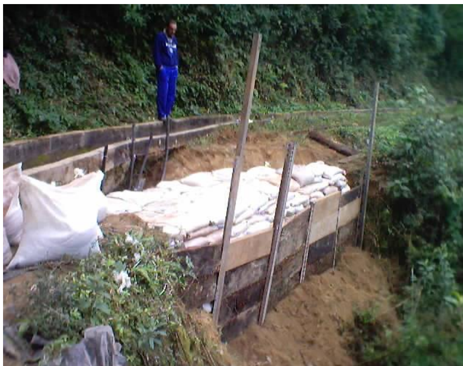
Figura 29- Contenção na encosta ao longo de um canal . Sacos de solo cimento contidos com cantoneiras metálicas
