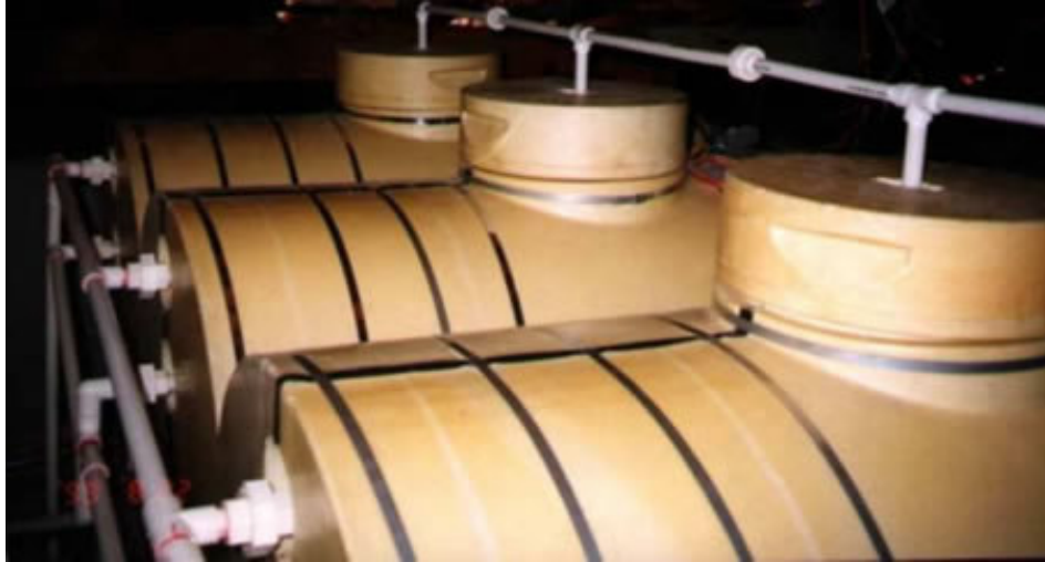
FIGURA 3.4: Sistema de armazenamento.
