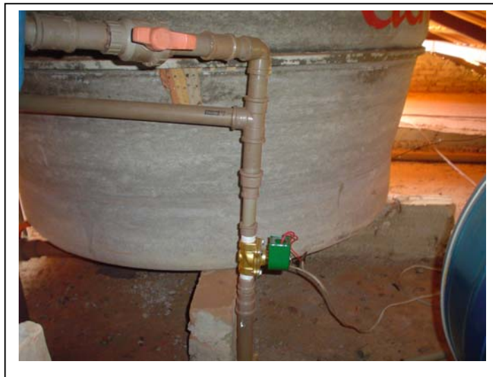
Foto 4.2 – Válvula solenóide instalada
