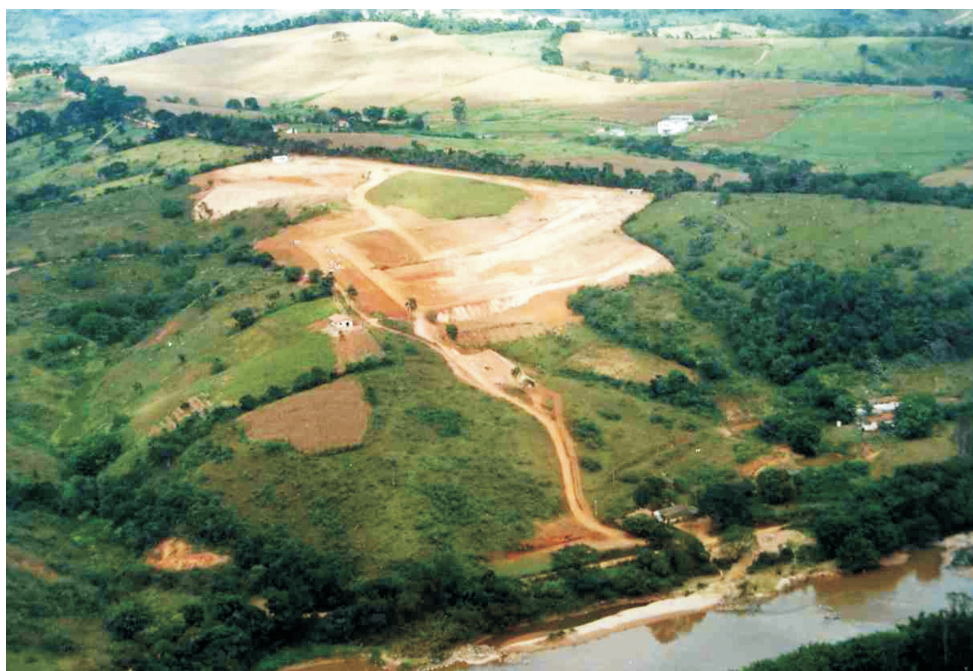
FIGURA 10 - Remoção da cobertura vegetal para a infraestrutura básica da UHE FUNIL. Fonte: Acervo Prefeitura Municipal de Ijaci-MG (2001).
