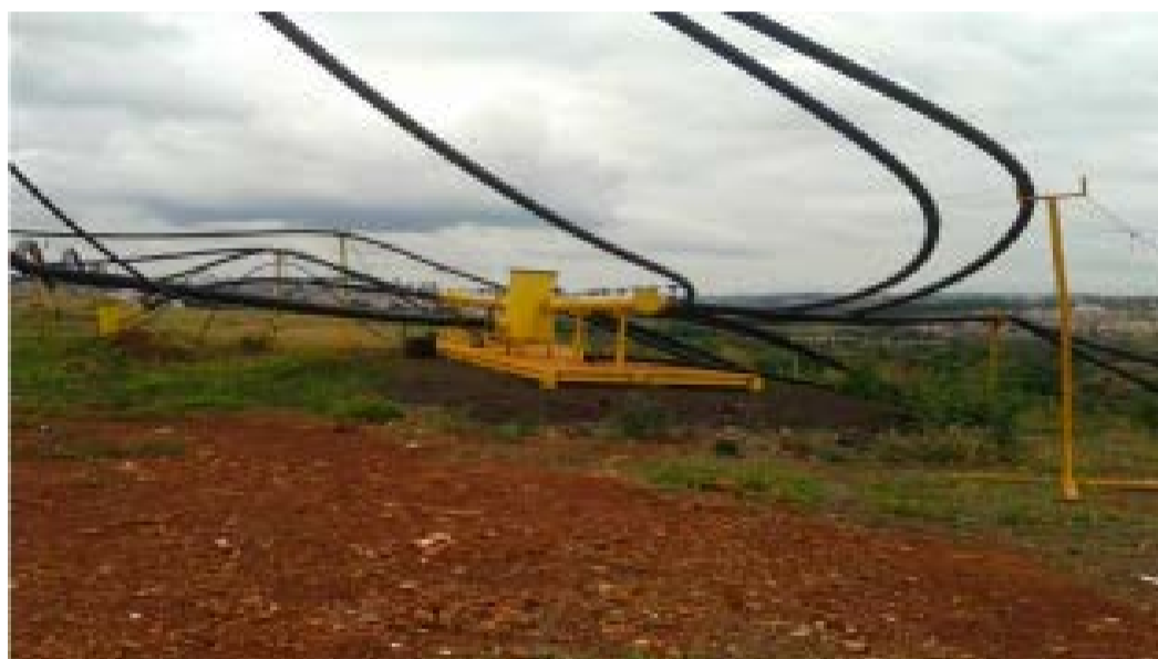
Figura 01 - Subestações de regulação de fluxo
