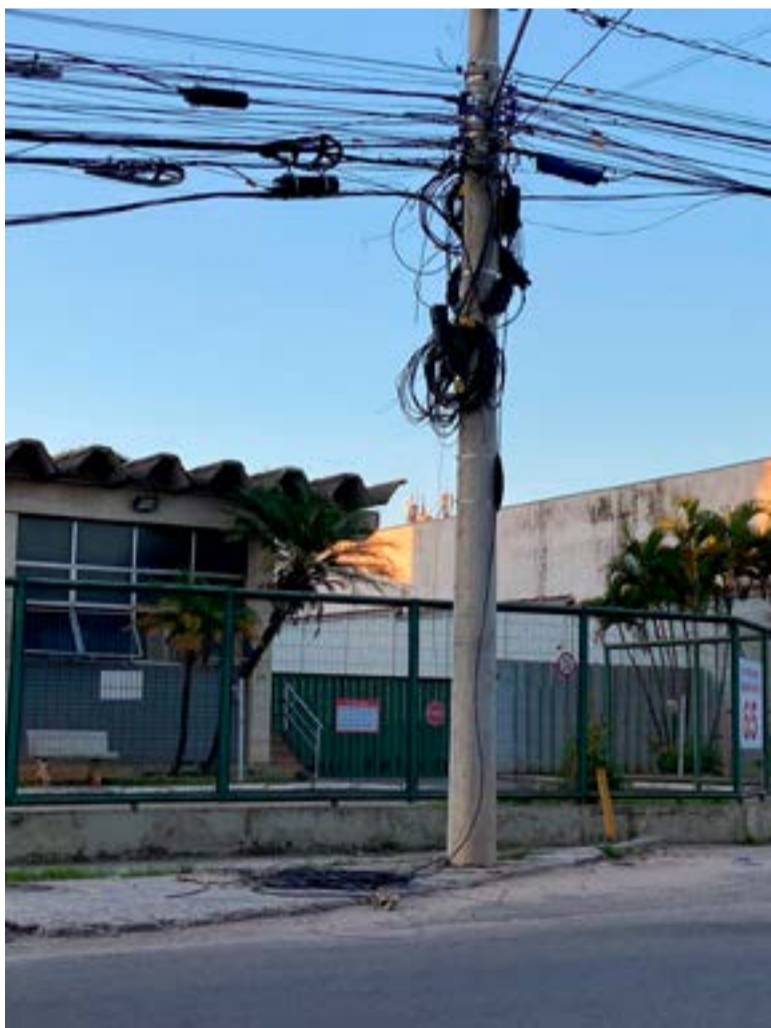
Foto 1 – Cabos “mortos”, soltos e emendas irregulares em Contagem – Minas Gerais
