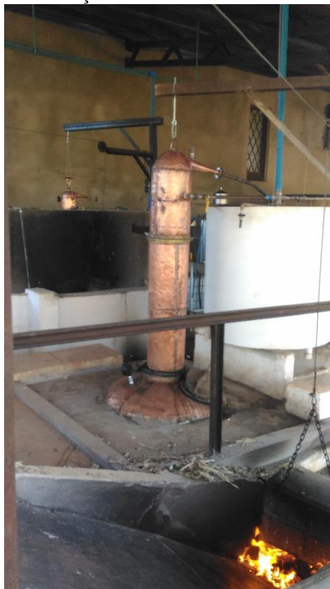
Figura 6 - Estrutura de destilação constituída por alambique, tubulações, tanque de resfriamento e tubulações.
