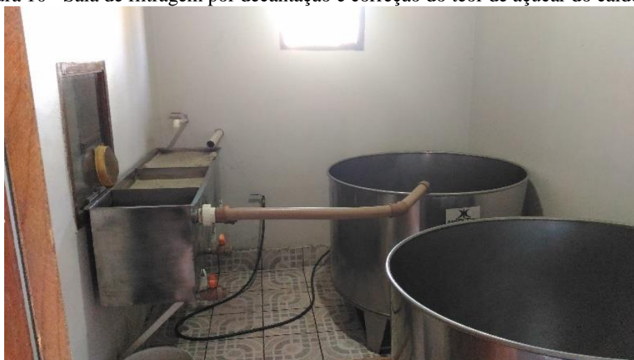
Figura 10 - Sala de filtragem por decantação e correção do teor de açúcar do caldo.
