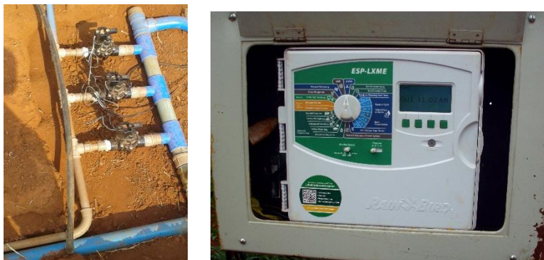
Figura 2 Válvulas solenoides e painel de controle da irrigação por pulsos.
