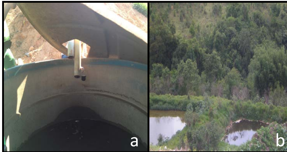
Figura 18 Tanque de Coleta do chorume do Aterro Controlado de Divinópolis/MG e (b) lagoa de chorume do Aterro Controlado de Divinópolis/MG
