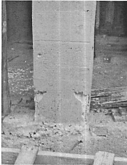
FIGURA 8.7 - Defeitos de concretagem de pilar.
