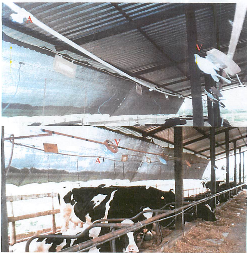
FIGURA 5. Vista interna do galpão mostrando a disposição dos ventiladores (V) e dos aspersores (A).
