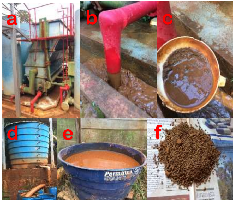
Figura 3. Etapas de processamento do lodo da ETA.
