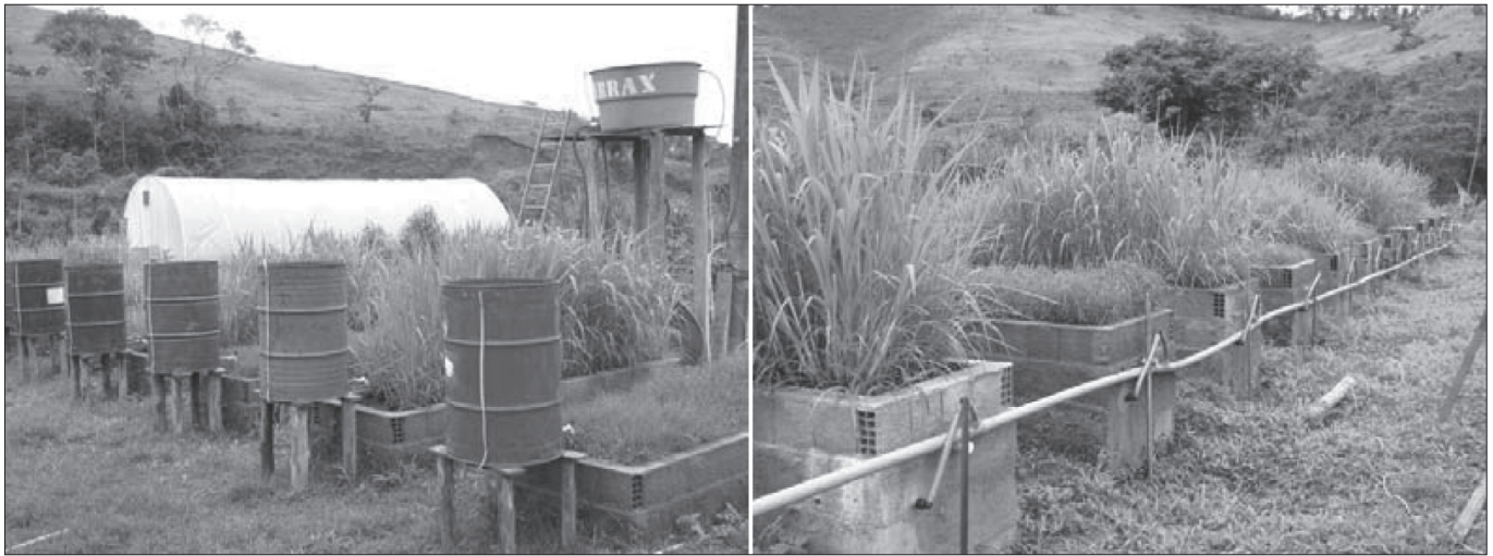
Figura 1 – Vista geral dos sistemas de distribuição da ARL e da rede coletora do efluente dos SACs
