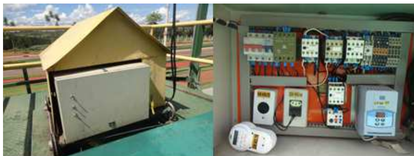
Figura 3 Unidade automática de raspagem de espuma e painel para automação
