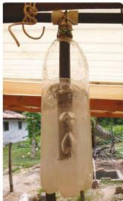
A válvula de segurança é colocada no início da condução de biogás, perto do biodigestor, para se verificar diariamente se há necessidade de mais água.
