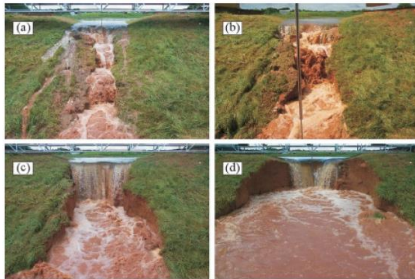
Figura 10 - Galgamento com erosão por fenda frontal em material coeso.
