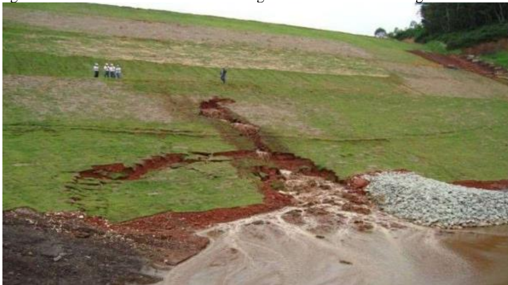
Figura 18 - Processo erosivo interno e surgência no talude da Barragem de Fundão.
