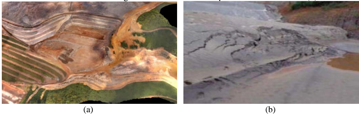
Figura 21 - Recuo da ombreira esquerda da Barragem do Fundão em (a), e surgência, trincas e escorregamento na ombreira esquerda – El. 860 m em (b).
