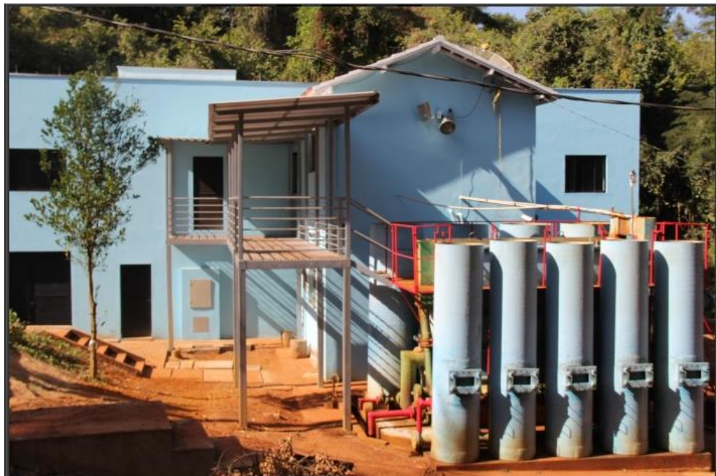
Figura 14 - Estação de tratamento de água (ETA/UFLA).
