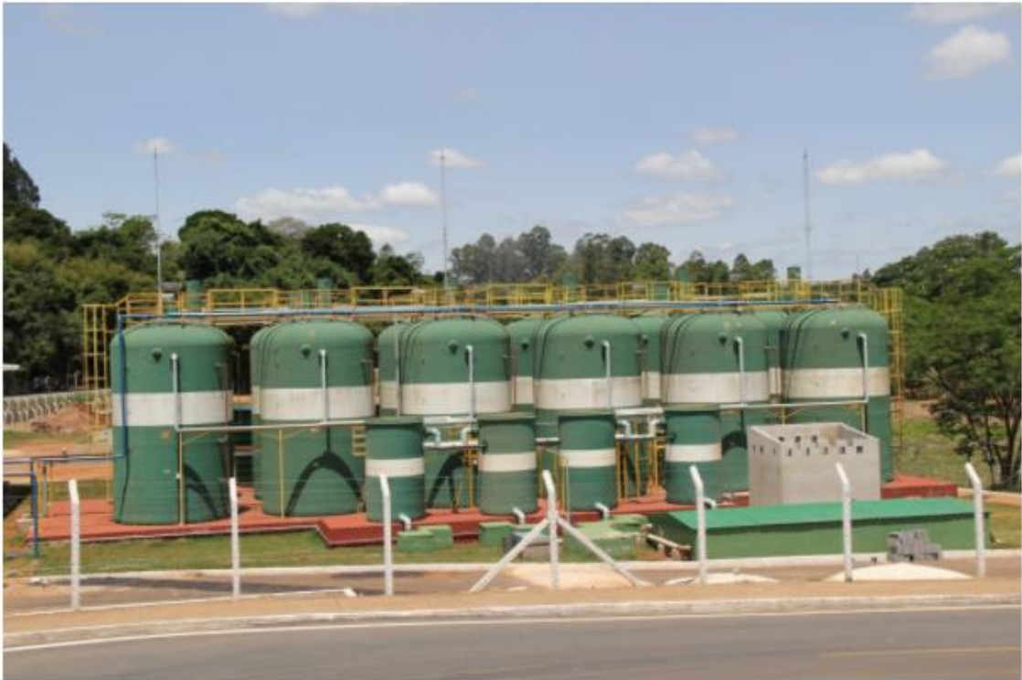
Figura 15 - Estação de tratamento de esgoto (ETE/UFLA).
