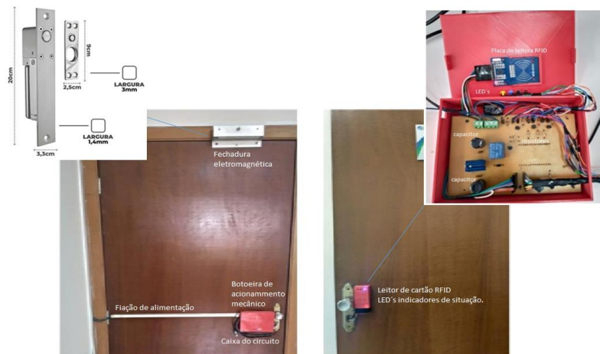
Figura 12 - Leitor instalado na porta da sala (lado interno e lado externo)
