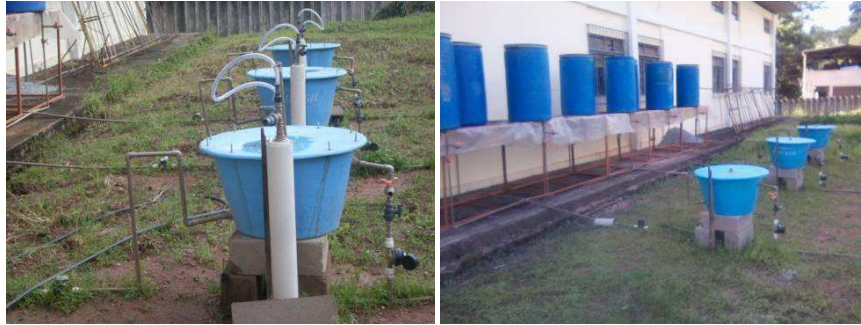
Figura 13 Hidrômetros instalados na entrada e saída dos reatores anaeróbios para medição de vazão
