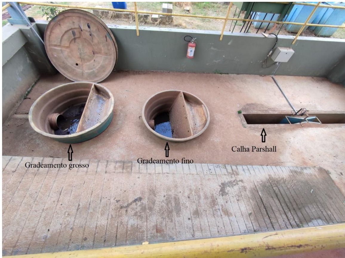
Figura 4 - Tratamento preliminar (gradeamento) da ETE-UFLA.
