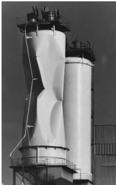
Figura 6.2: Explosão de silo
