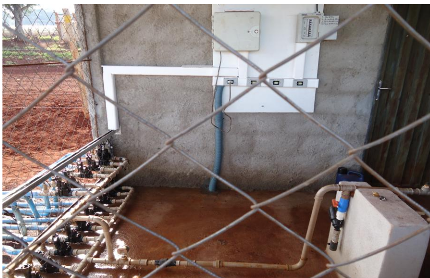
Figura 3 Controlador Lógico Programável e cabeçal de controle
