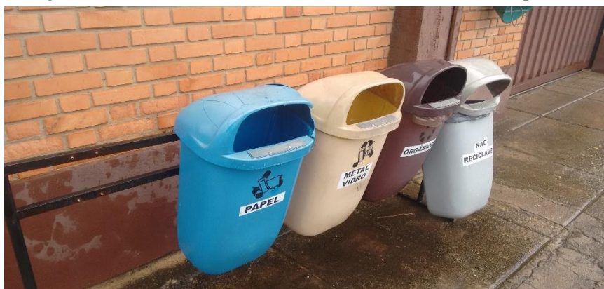
Figura 46 - Coletor externo instalado no setor Quadra Poliesportiva.
