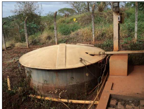
Figura 8 Vista lateral do Tanque de Acidificação e Equalização (TAE).
