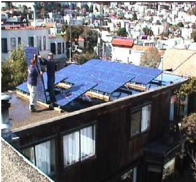
Figura 04: Equipamentos fotovoltaicos para telhados 2
