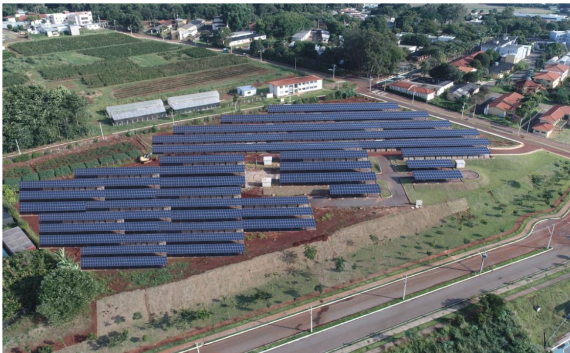
Figura 3.6 – Mini-usina Centro de Eventos
