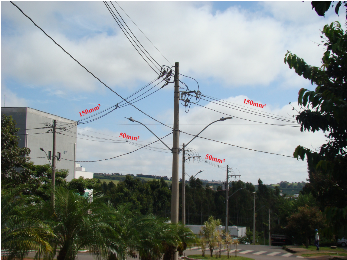
Figura 3.4 – Representação dos Trechos com Cabos de 150mm 2 e 50mm 2
