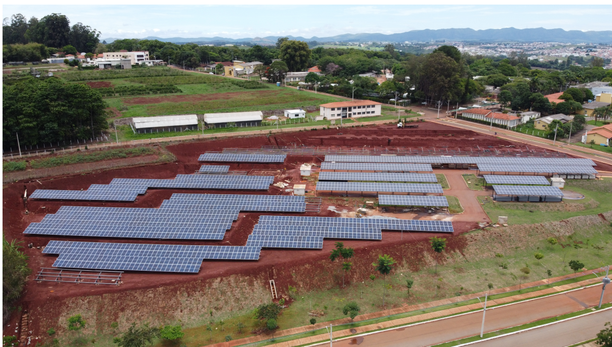
Figura 5.6 – Mini-usina fotovoltaica da UFLA
