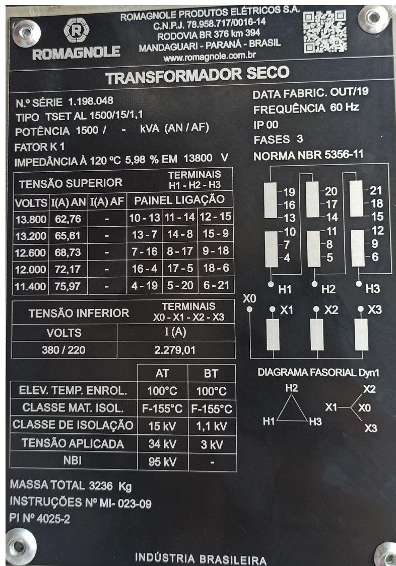
Figura 5.7 – Transformador de 1,5MVA para atendimento à fotovoltaica
