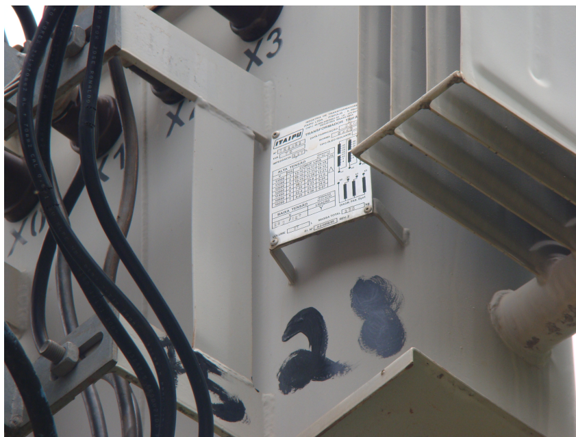
Figura 5.4 – Placa de dados do Transformador 28
