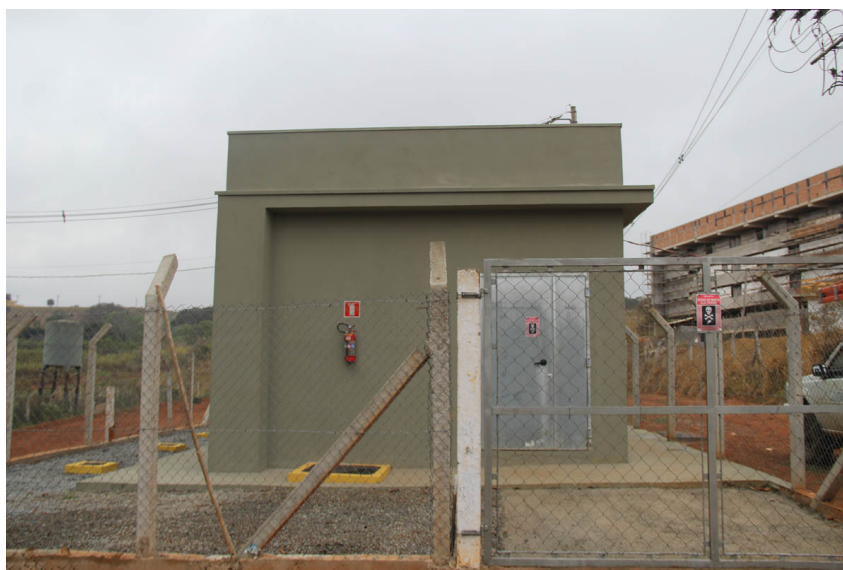
Figura 5.2 – Cabine de medição e proteção da UFLA localizada próxima ao Lavrastec
