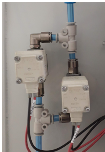
Figura 3.9 – Válvulas de acionamento elétrico tipo ON/OFF.
