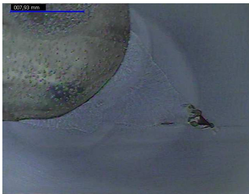
Lado A: Ausência de trincas e porosidades . Presença de falta de fusão.
