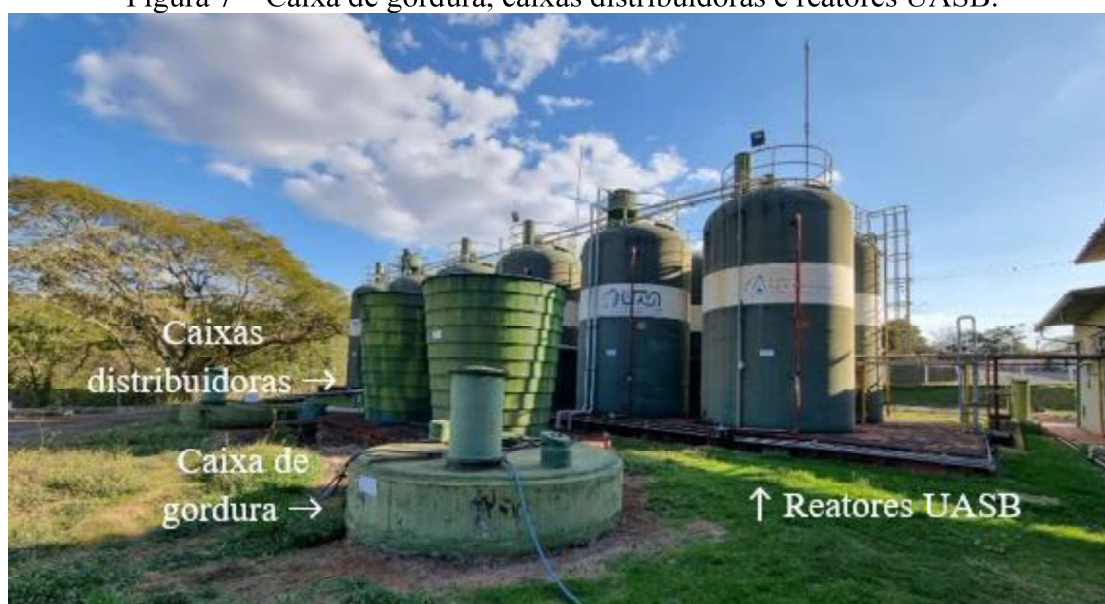
Figura 7 – Caixa de gordura, caixas distribuidoras e reatores UASB.
