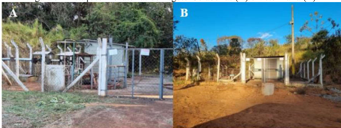
Figura 3 – Estações Elevatórias de Esgoto Goiabeiras (A) e Veterinária (B).
