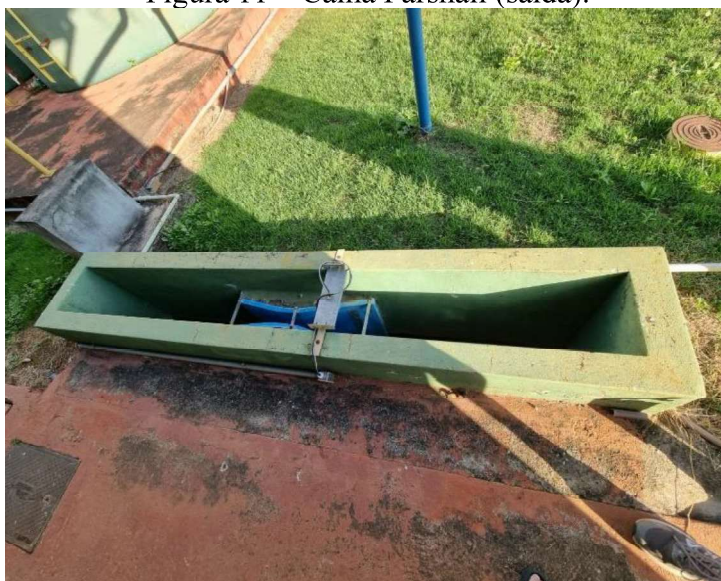
Figura 11 – Calha Parshall (saída).
