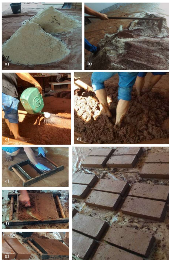
Figura 1 - Sequência de produção do adobe: (a) e b) mistura dos componentes secos; c) adição de água; d) homogeneização da mistura com os pés; e), f) e g) moldagem dos adobes em forma de madeira e h) adobes desmoldados.
