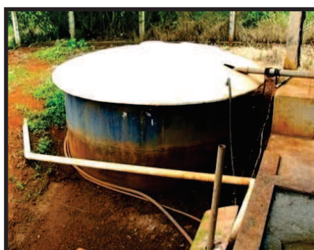
Figura 6 Tanque de acidificação e equalização (TAE), em vista lateral
