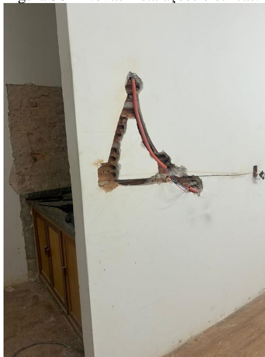
Figura 30 – Novas instalações elétricas.
