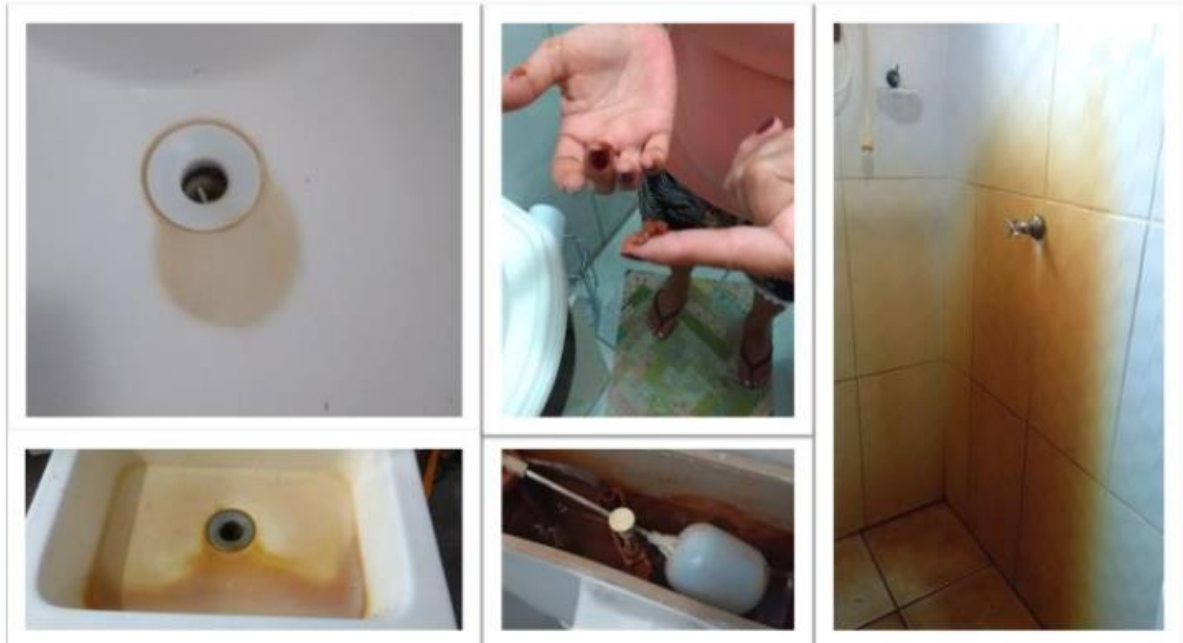
Figura 3.2 – Problemas causados por águas ferruginosas subterrâneas.
