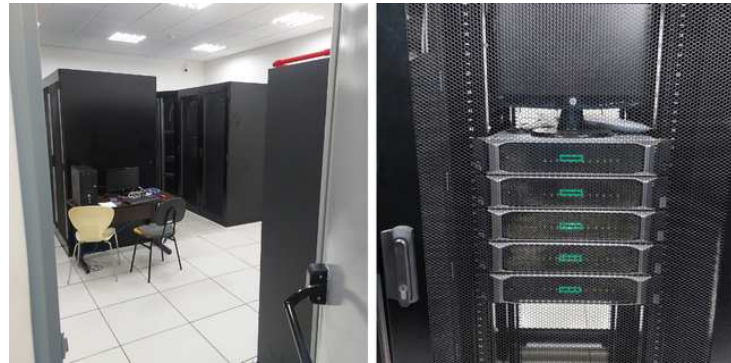
Figura 4.13 – Data Center da UFLA.
