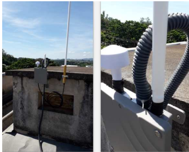
Figura 4.9 – Gateway Instalado na UFLA.
