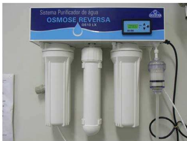
Figura 14 – Aparelho de destilação por osmose reversa.
