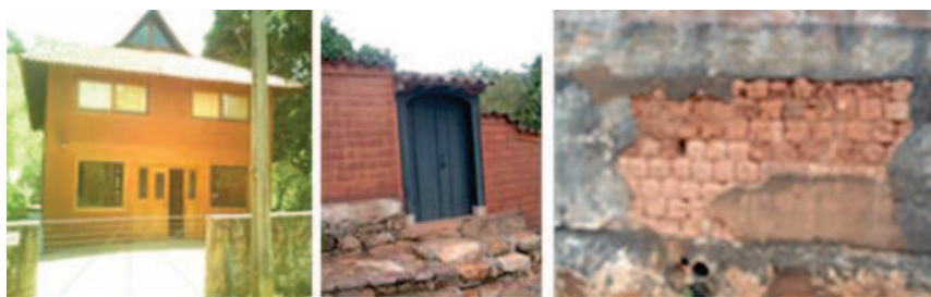
Figura 2 Construções atuais em Tiradentes MG e parede com patologias
