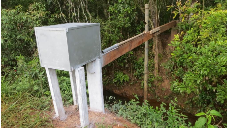
Figura 8 Seção controle do ribeirão Jaguará, juntamente com a estrutura de abrigo e instalação do linígrafo
