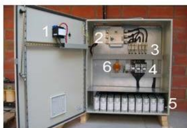
Figura 15 - Quadro de controle de fator de potência, composto por: 1) Controlador; 2) Chave seccionadora; 3) Fusíveis; 4) Contatores; 5) Capacitores; 6) Fonte de alimentação.
