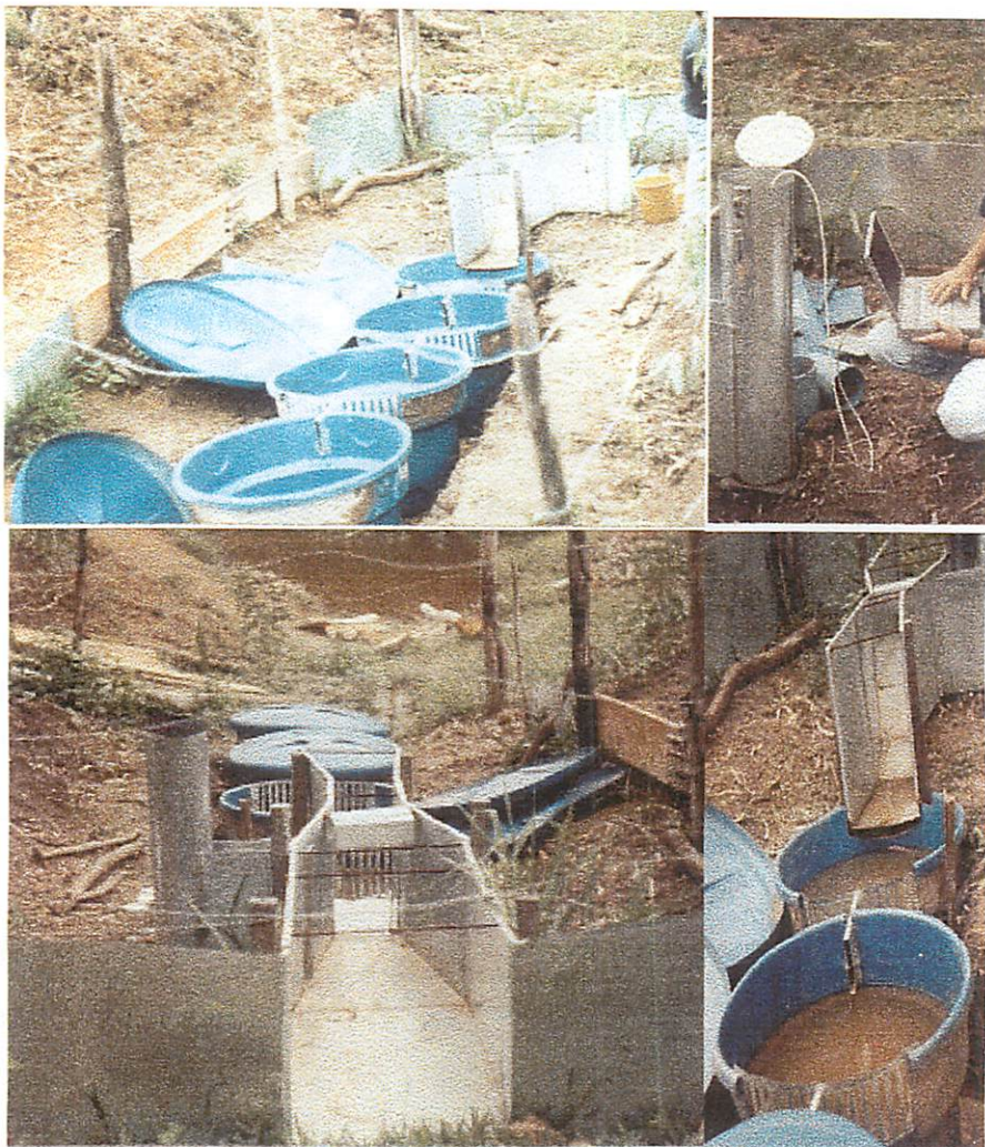
FIGURA 3. Calha Parshall e caixas coletoras de sedimentos instaladas na seção de controle de microbacia hidrográfica da região de Lavras, MG, com detalhes do poço tranquilizador, deflúvio coletado e descarregamento dos dados.
