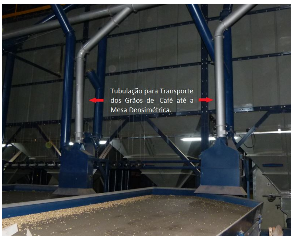
Figura 3.17 – Tubulação suspensa para transporte dos grãos de café até a mesa densimétrica
