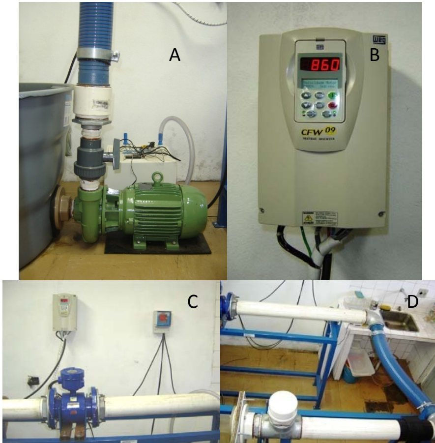
FIGURA 2 Detalhes dos equipamentos utilizados no aparato hidráulico. Bomba centrífuga e registro de entrada (A); inversor de frequência (B); medidor de vazão (em azul) com leitor acoplado (C) e seção em curva feita por joelhos e tubo flexível (D).
