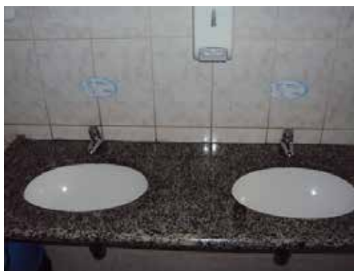
Figura 2 – Torneiras de pressão instaladas nos banheiros.
